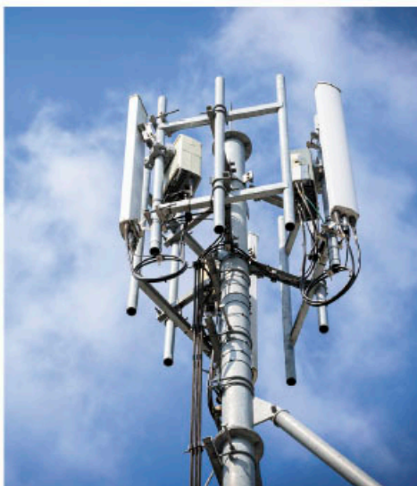
Figura 8 Antena de telefonía celular
